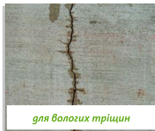
проникає в найтонші тріщини
